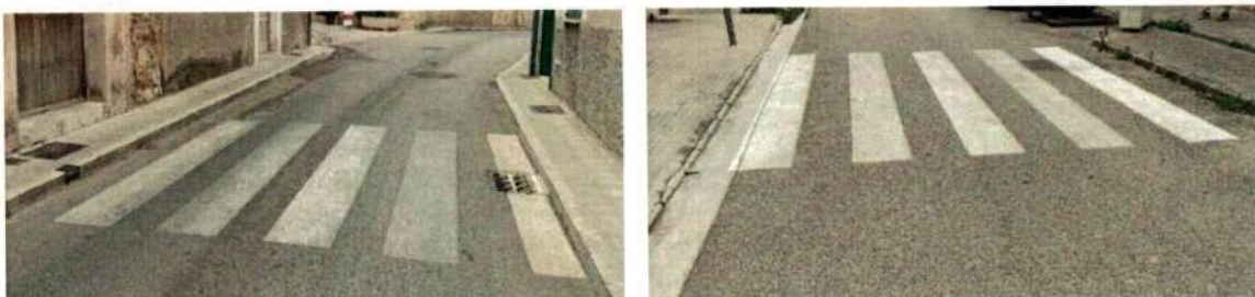
Passos de vianants no accessibles
